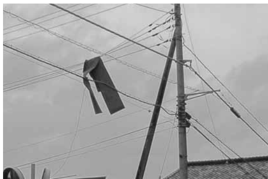
電線にひっかかったトタン
