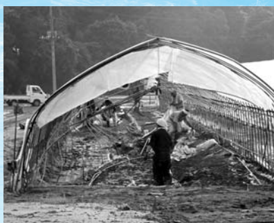
被害を受けたビニールハウス
