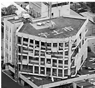
↑ 熊本地震により倒壊した庁舎『熊本県宇土市役所』
