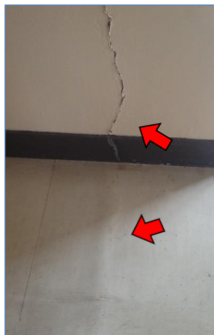
↓ ひび割れの状況
