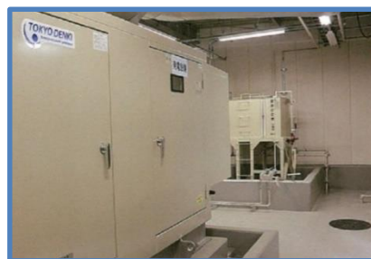
自家発電機（那珂川町）
